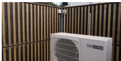
室外機周り (神奈川県)
