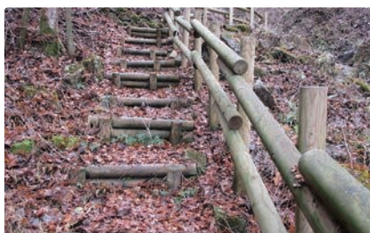
階段や手すり 木柵も防虫防蟻で長寿命
